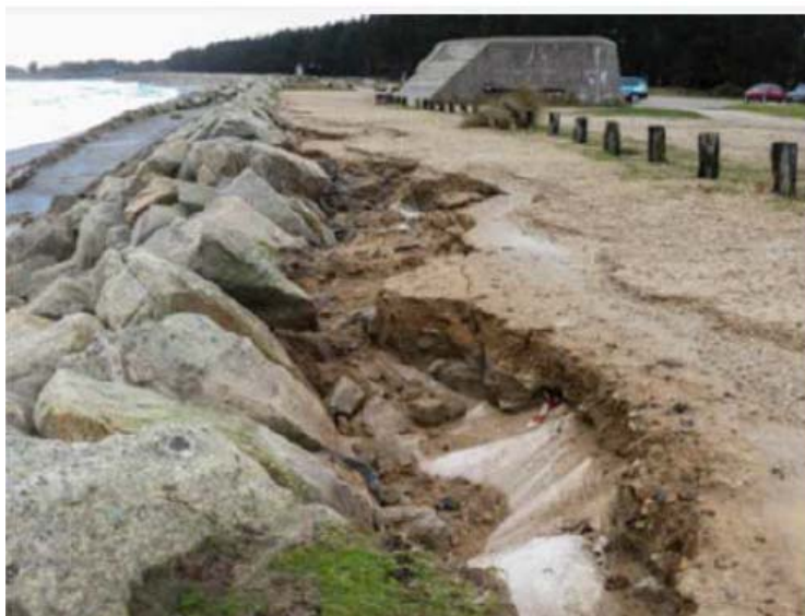
Anomalie constatée sur la crête des enrochements de la plage de Cleut Rouz (photo site internet association pour la sauvgarde du Pays Fouesnantais)
