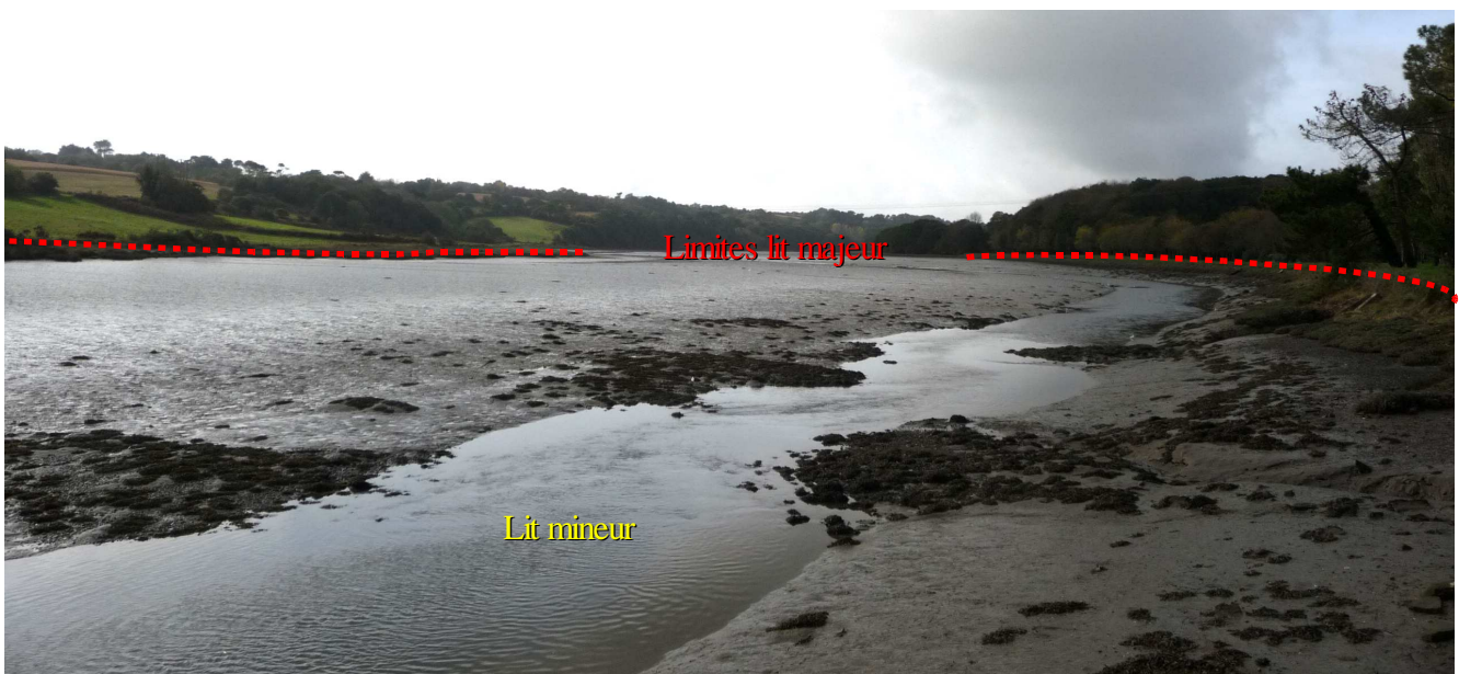
Photo 17 : Le Goyen à marée basse sur une berge artificialisée en rive droite (commune de Pont-Croix)
